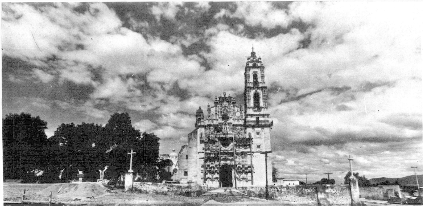
Vista general del atrio y fachada del templo de San Francisco Javier en proceso de restauración.
