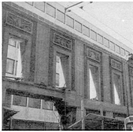
Fachada de la antigua Casa de Moneda, dentro del recinto del Palacio Nacional. La casa fué arrasada, y la fachada que puede ser restaurada ha estado abandonada. - Detrás se construyen oficinas modernas para la Secretaría de Hacienda.
